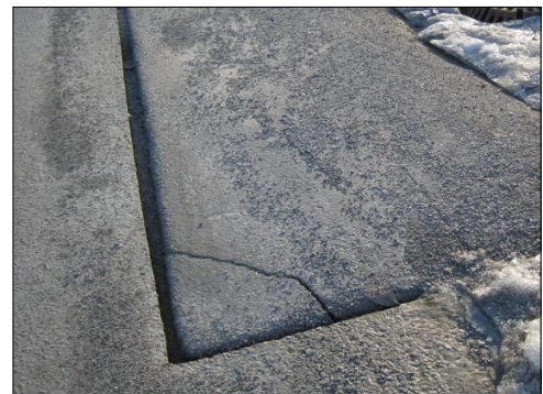
Åpen skjøt pga. manglende klebing og fortanning.
