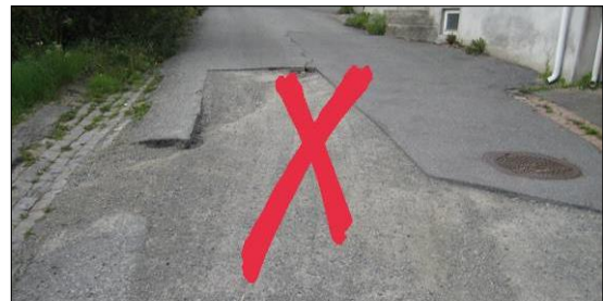
Feil utført skjæring; Entreprenør har midlertidig ansvar for vedlikehold av dekket.
