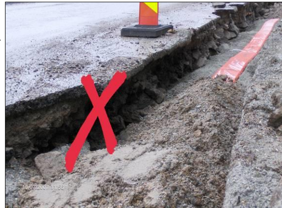
Utrasing av grøfteside. Her må det foretas skjæring av asfalt og justering av grøfteskråning.
