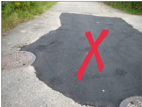
Feil istandsetting – ikke godkjent.
